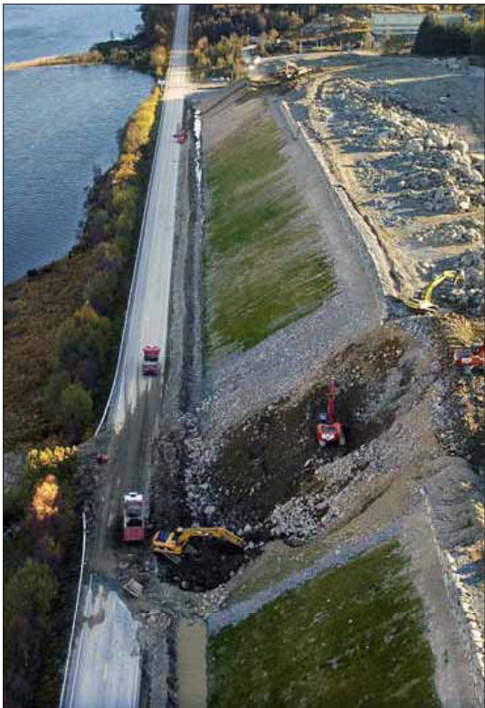
KOSTBART: Anleggsleder Åsbjørn Skrettingland i Risa anslår at det ville kostet 20 millioner kroner ekstra, like mye som hele Skurve-kontrakten, dersom masse fra Skurve skulle blitt kjørt vekk og erstattet med mer drenerende masse utenfra. Her er rasstedet på E 39.
